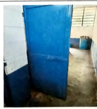
Foto 10: MODULO A Servicios sanitarios. Colocacion de piso en base de concreto en mal estado. Mantenimiento de puertas de metal
